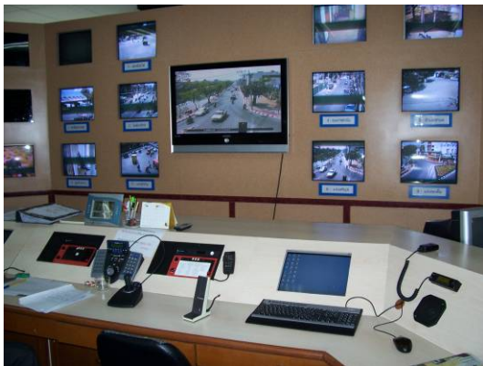
แผงควบคุมระบบและวิทยุสื่อสาร
