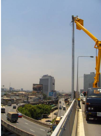
เสากล้องฯ สูง 8 เมตร ติดตั้งบนขอบทางพิเศษฯ
